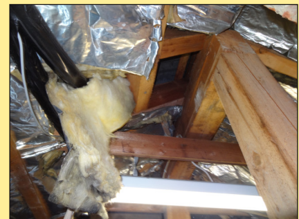
Abb. 14: Schadhafte Dämmung des Daches
